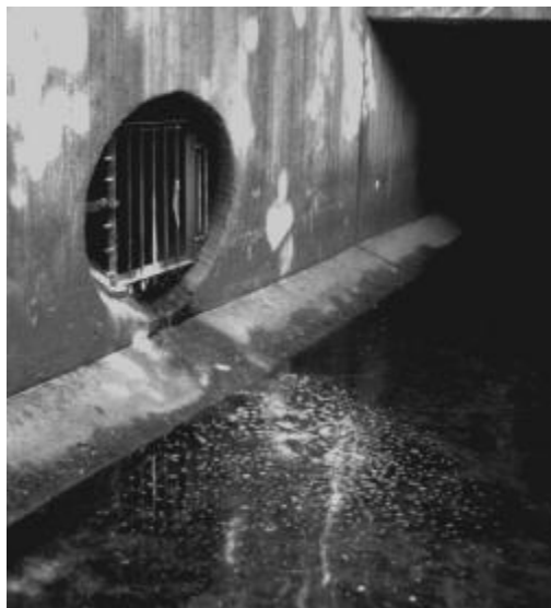
Bild 2: Ausgeschüttetes Putzwasser hat in Niedrigwassersituationen unmittelbare Schädigung. – Der Durchmesser des Zulaufs läßt die hydraulische Situation beim Starkregeneignis erahnen.
